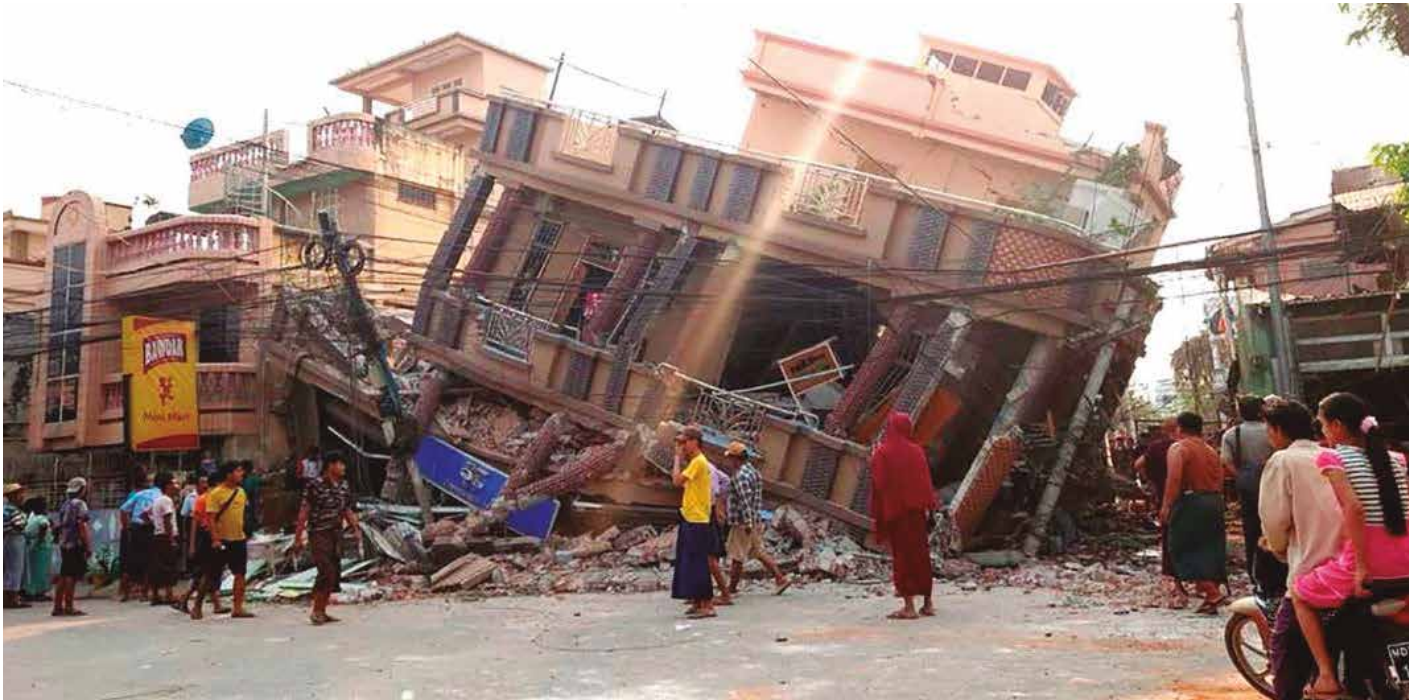
Abalo sísmico de magnitude 7,7 causou danos significativos a edifícios na região de Mandalay, segunda maior cidade de Mianmar
