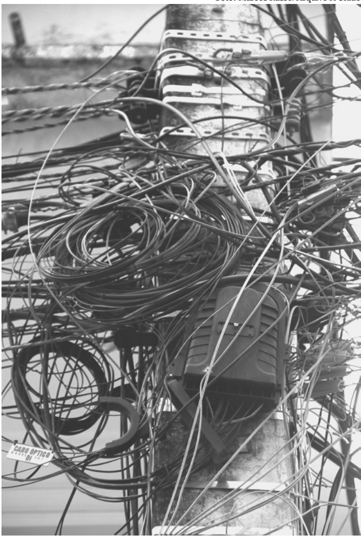
Sobrecarga na estrutura dos postes pode gerar vários problemas
